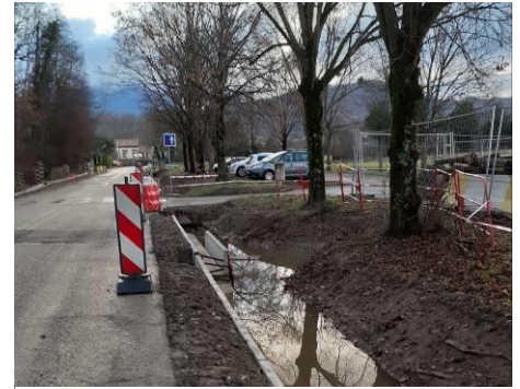
Montée des eaux dans la zone de chantier lors de fortes pluies mi-décembre © RNR.
