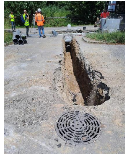
Premiers travaux de séparation des eaux du bassin versant naturel et des eaux de voirie le long de la route du Plâtre.
